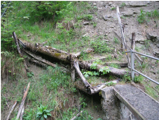
Bildlegende: Zivilschutz-Arbeitsplatz am Herisauer Stösselbach: Vor der Sanierung. Bild: ZS AR
